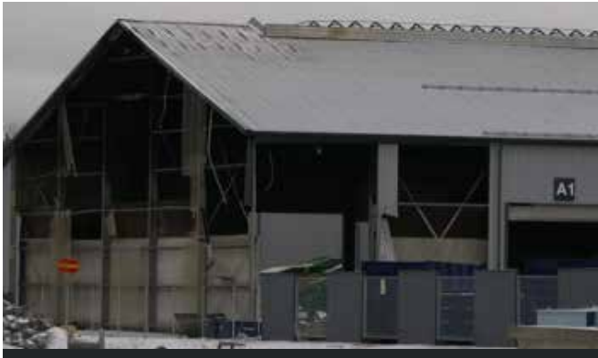
Teräsrakenteiden vaurioita, varastohallin väliseinä
